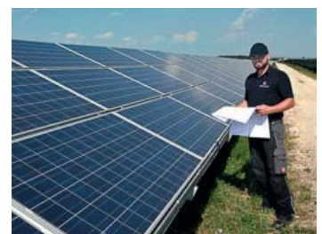
Ingenieur des PI-Berlin überprüft PV Kraftwerk
