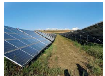
Untersuchtes PV-Kraftwerk in Italien
