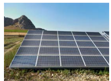
Untersuchtes PV-Kraftwerk in Italien
