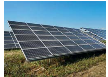
Untersuchtes PV-Kraftwerk in Italien
