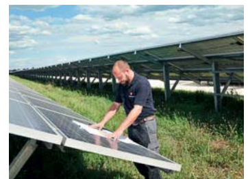
Ingenieur des PI-Berlin überprüft PV Kraftwerk
