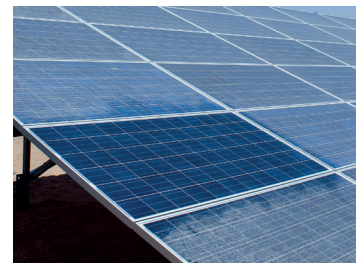
Gereinigtes PV-Modul neben verschmutzten Modulen
