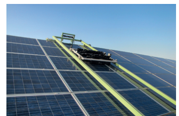
Ecoppia E4 Reinigungsroboter
