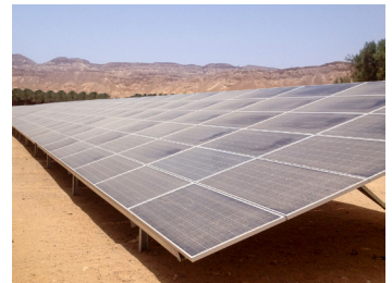
Verschmutzte Module einer 40 MW-Anlage in Israel
