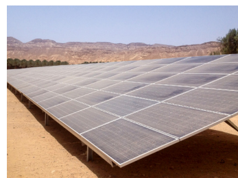
Verschmutzte Module einer 40 MW-Anlage in Israel
